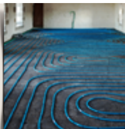
Chauffage au sol.
